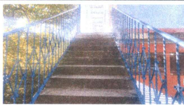
Foto 4: Sustrución de baranda de metal de gradas de la cancha del establecimiento
